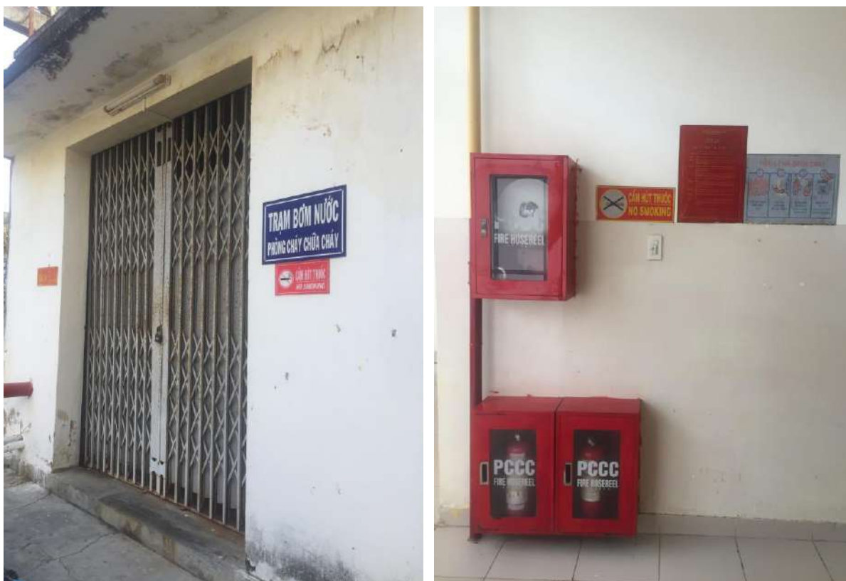
Hình PLI.19. Trạm bơm nước PCCC, tủ chứa các dụng cụ chữa cháy
