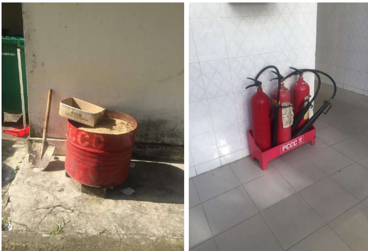
Hình PLI.20. Thùng chứa cát, xẻng và bình chữa cháy đặt tại bệnh viện
